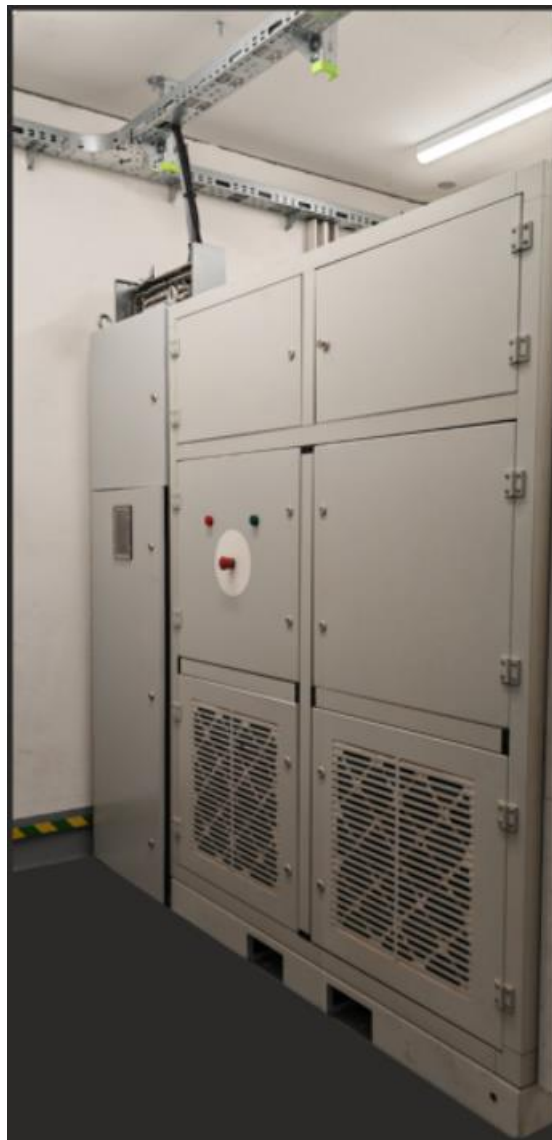
Fot. 1: Przetwornica PNT3 w kontenerze KSP
